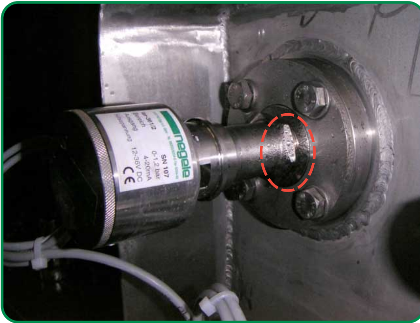
Bild 1: Kondensation am Füllstandssensor LAR-361
